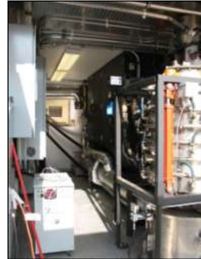
Gas Production Module
