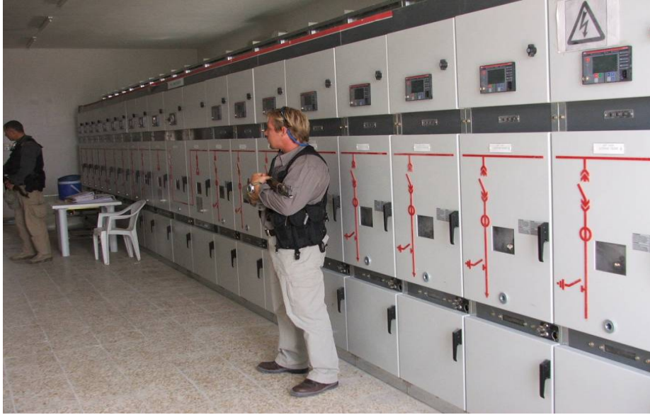
Site Photo 2: 11 kV switchgear
